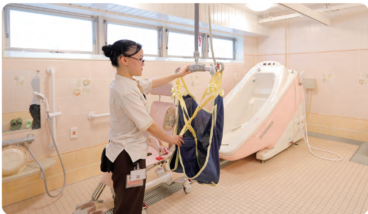
浴室には、天井レールタイプのリフトを設置。ゲストを脱衣の上リフトに移乗させて浴槽まで搬送し、そのまま浴槽に降ろして入浴させることができる。介護スタッフに大きな負荷がかかる入浴介助が、大幅に軽減された
